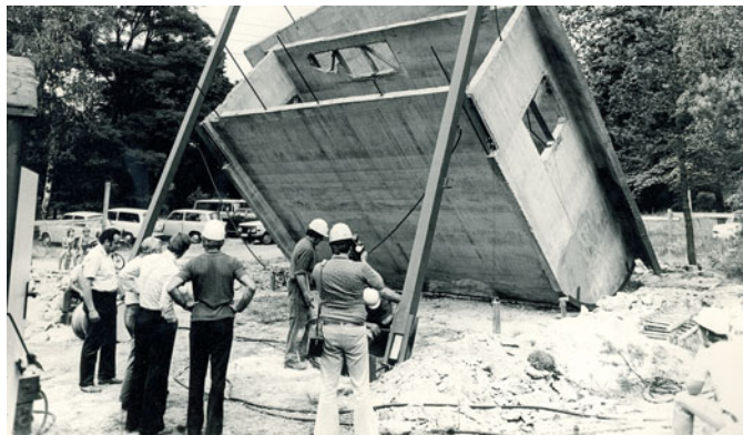
November 1975: Der von Wilfried Stallknecht und Günter Schmidt an der Bauakademie der DDR entwickelte Experimentalbau im Gleit-Kipp-Verfahren entsteht (Alle historischen Fotos: Wissenschaftliche Sammlung, IRS Erkner)
